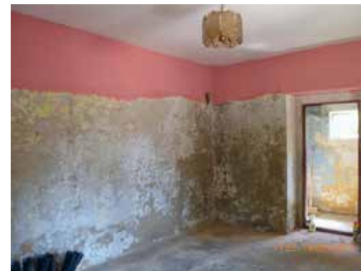
Pro lepší vysychání stěn odstraňte výmalbu.
