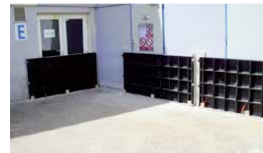
Průmyslové protipovodňové zábrany.
