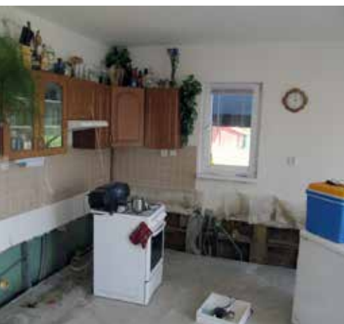
Odstraňte všechny překážky, které brání vysychání. Zejména dřevěné a sádkartonové obklady.
