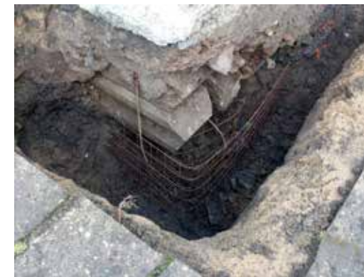
Porušené základy podbetonujte.
