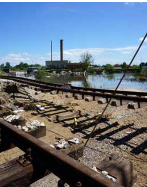
Velké povodně mohou poškodit důležitou dopravní infrastrukturu.
