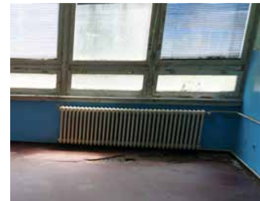
Popraskání podlahy vzlakem vody při zaplavení.
